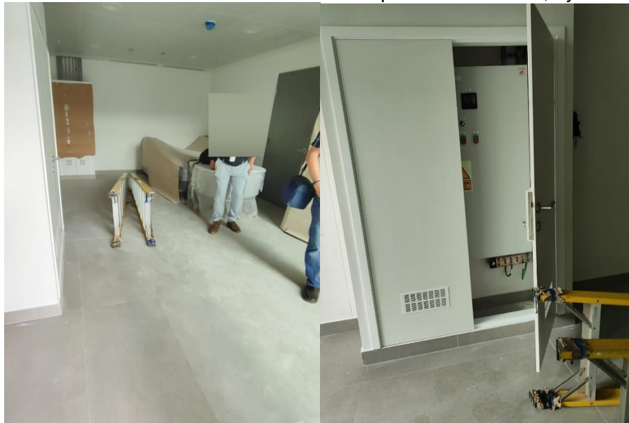
Fotos 7 y 8. Kitchenet de Primer piso, alejada y con cajas de fuente de poder y maquinas que no deberían estar ahí.
