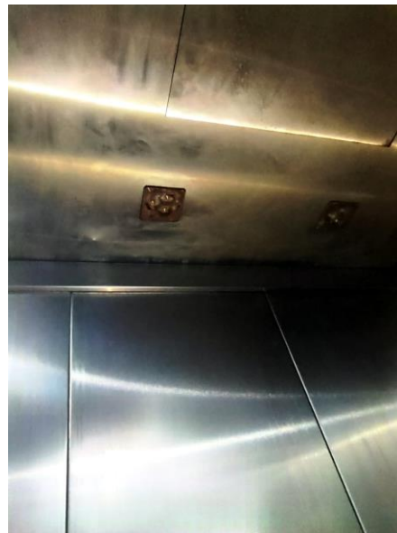
Foto2. Dicroicos y oxido en ascensores
